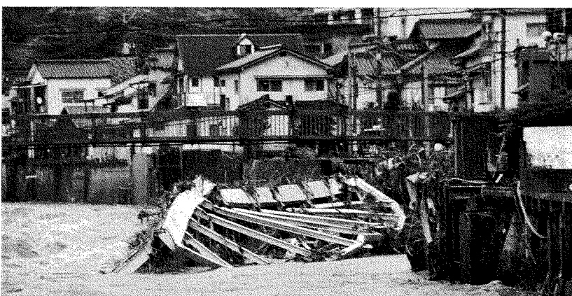
▲崩落して川に横たわる新天瀬橋(7月7日、日隈市議撮影)
